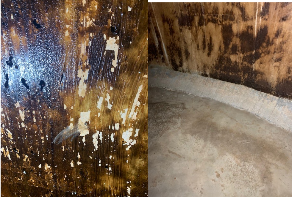
État Étanchéité intérieur du radier et des parois
