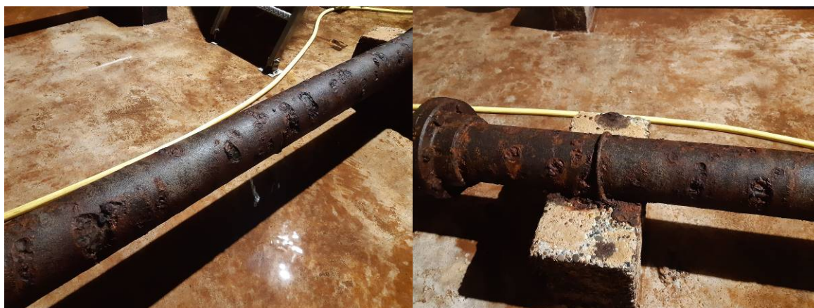
Conduites et équipements à l'intérieur du réservoir très corrodés
