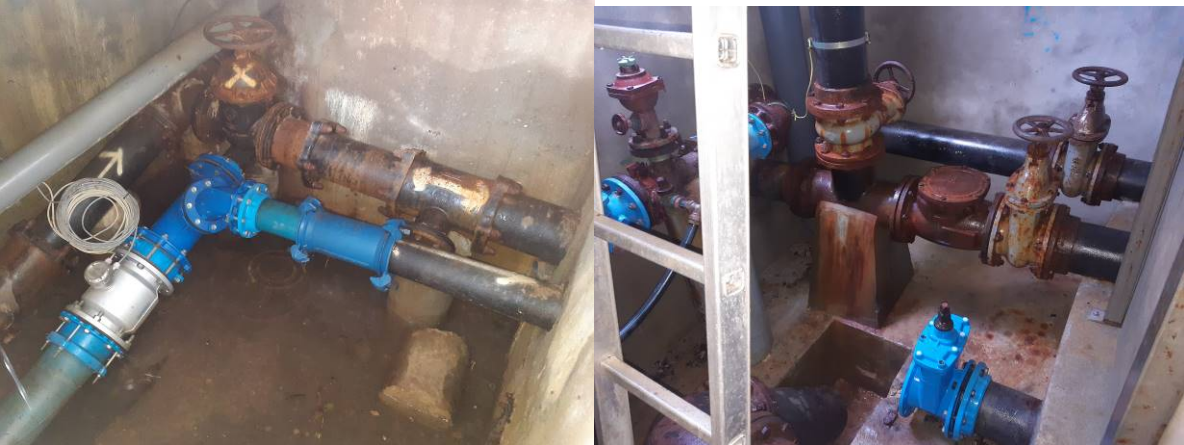
Conduites et accessoires dans la chambre de vannes très corrodés
