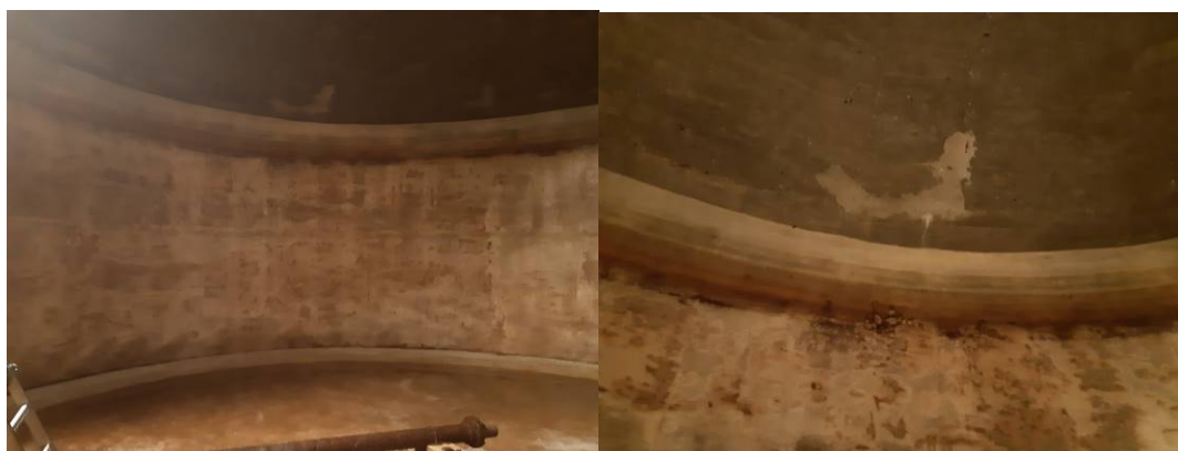
Acier apparent au niveau du dôme
