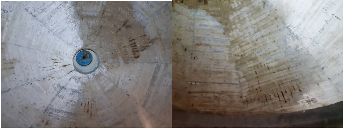
Acier apparent au niveau du dôme
