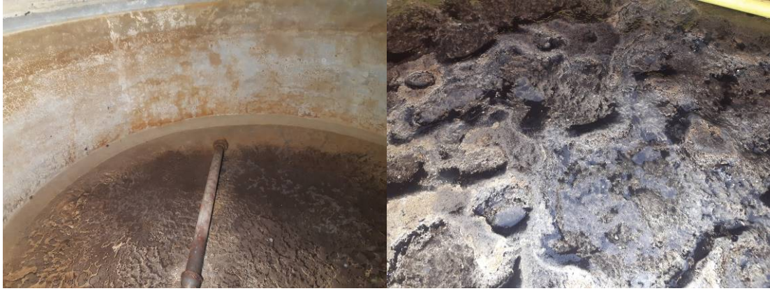
Radier et parois très endommagés
