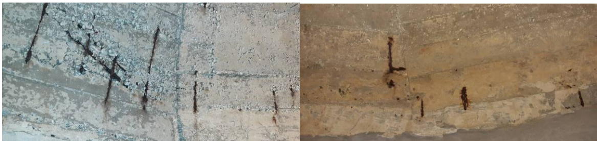
Acier apparent au niveau du dôme
