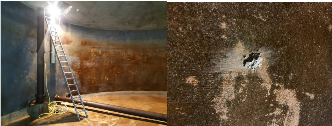
Radier et parois très endommagés
