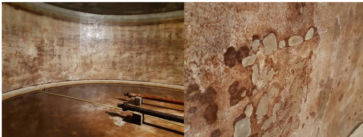
Radier et parois endommagés
