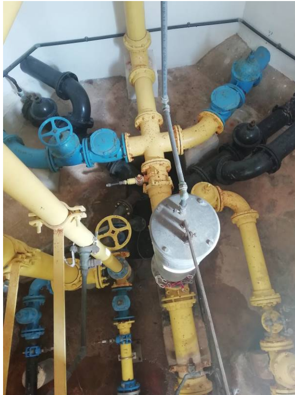
État des conduites dans la chambre de vanne
