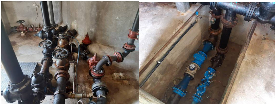
Conduites et accessoires dans la chambre de vannes très corrodés
