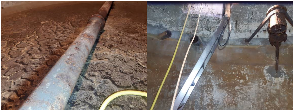
Conduites et équipements à l'intérieur du réservoir très corrodés
