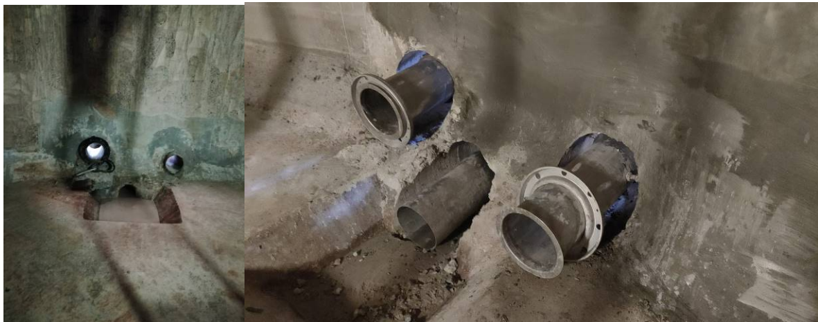
Suppression des anciennes conduites et mise en place des nouvelles avec traversée de cloison
