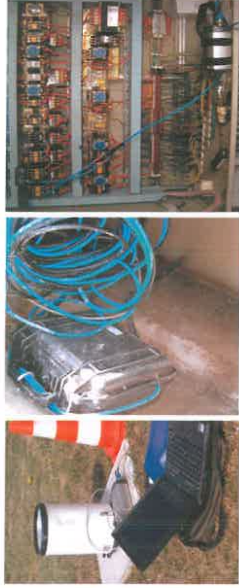
Fig. 2-a : Présentation de la station pluviométrique, de la sonde doppler et de l'appareillage sur le poste de relevage
