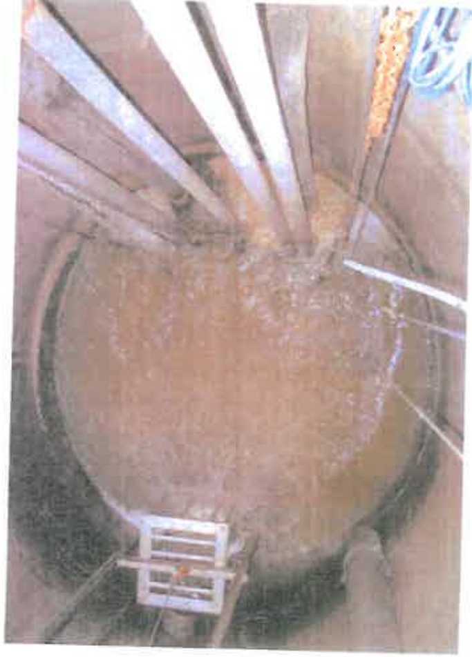
Poste de refoulement - Vue intérieure
