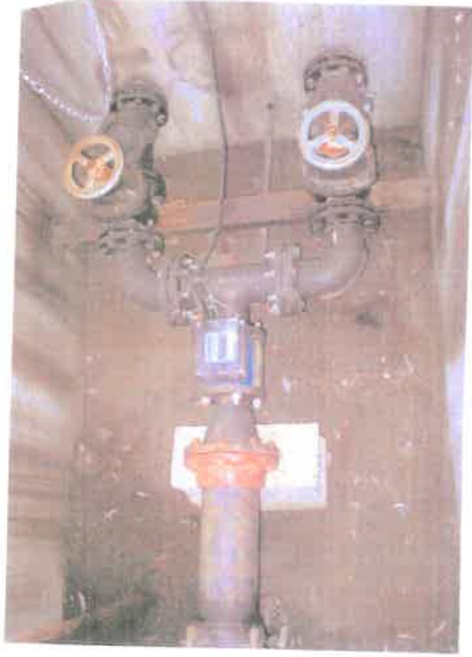
Poste de refoulement - Chambre des vannes
