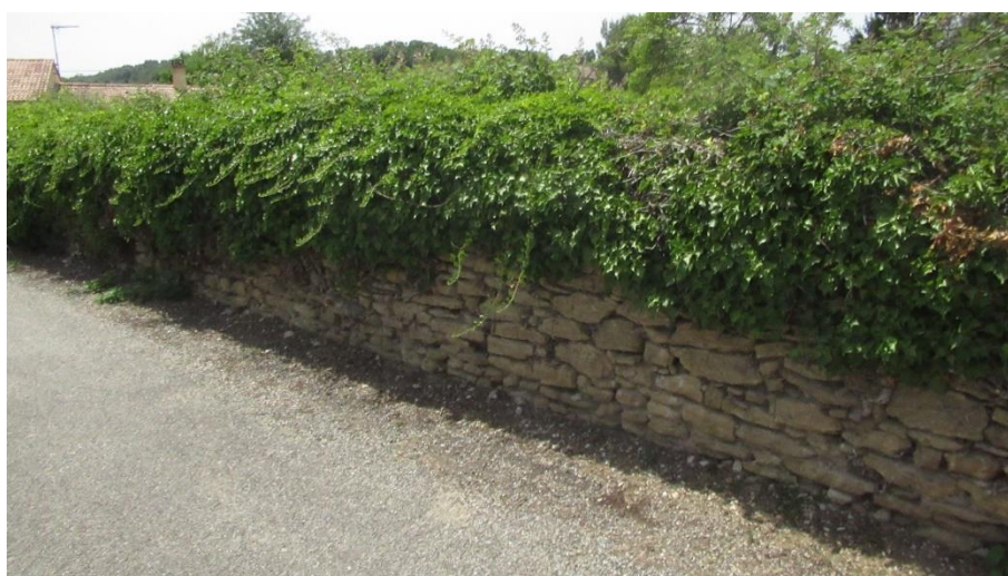
Photographie 7 – Mur en pierre cimenté n°2 (source : ECO-STRATEGIE, le 16/06/2022)
